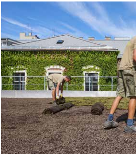
Im Zuge der Errichtung von 285 m 2 Gründächern wurde auch das Mittelhaus-Dach begrünt.
